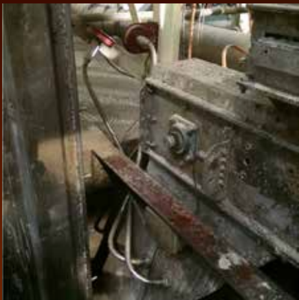
อุตสาหกรรมแผงจ่ายไฟฟ้าย่อย Panel board industry
